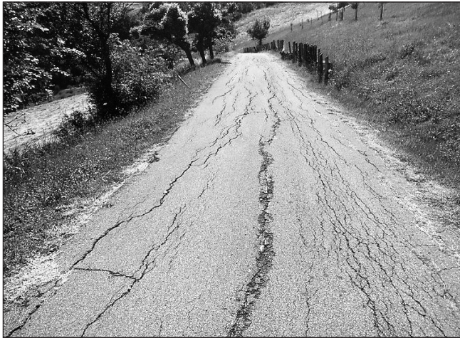
Fig. 26 – Fessurazioni lungo la strada di accesso a Cascina Gazzolo che possono anche evolversi in fenomeno franoso.
