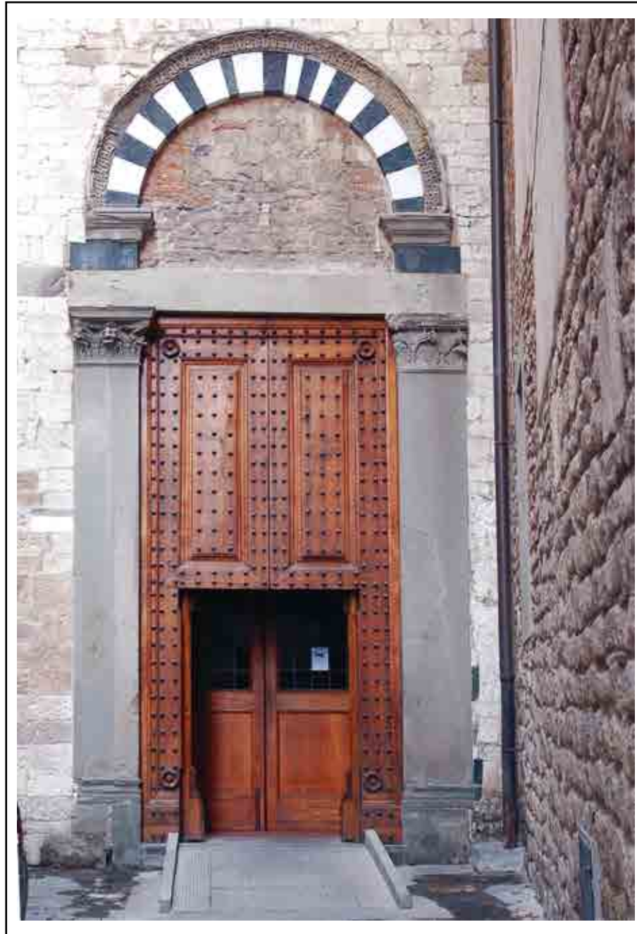
Fig. 22 - Facciata ovest della canonica di San Zeno, con avanzi di murature altomedievali (opera dell'autore).
