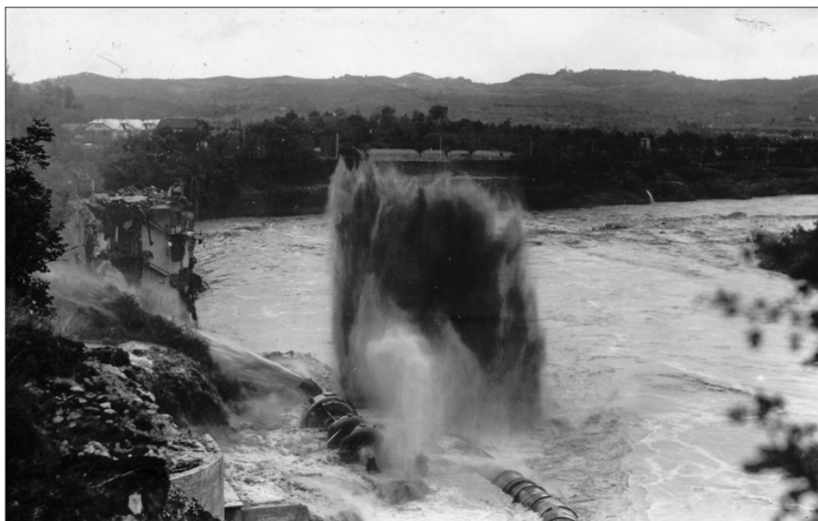
Figura 5 - La completa distruzione della centrale elettrica mentre la condotta forzata si sta svuotando.
