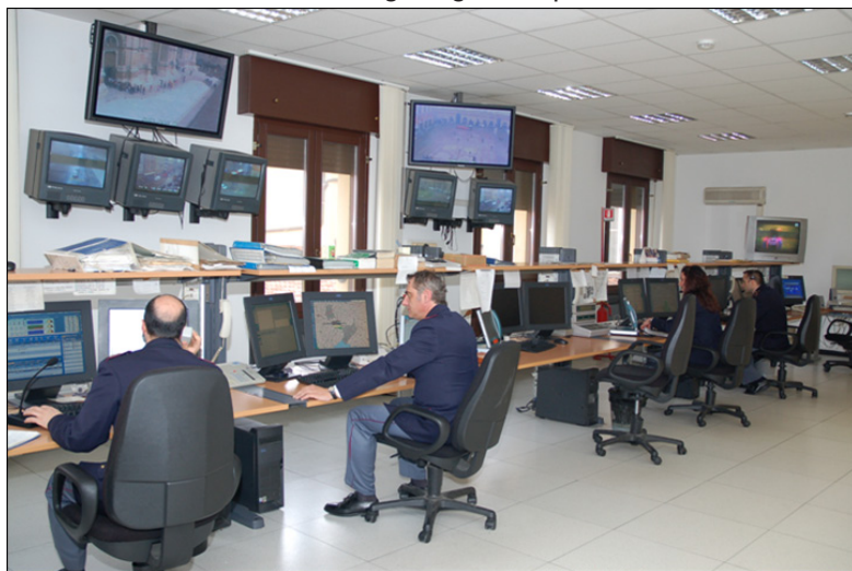
Fig.4 – Centrale di controllo
